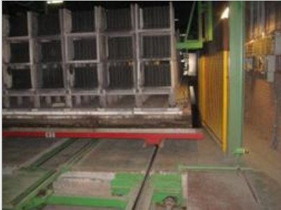
Gevaar aangereden te worden door ovenwagen.
