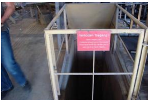
Toegang tot kelder onder installatie afgesloten en met verbodsmarkering
