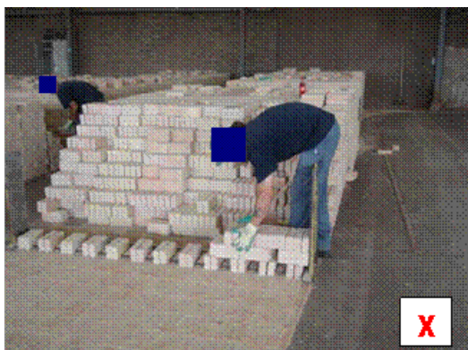
Foto: Medewerker bezig met sorteerwerkzaamheden. Hier worden tevens verschillende kleuren door elkaar gemixt.
